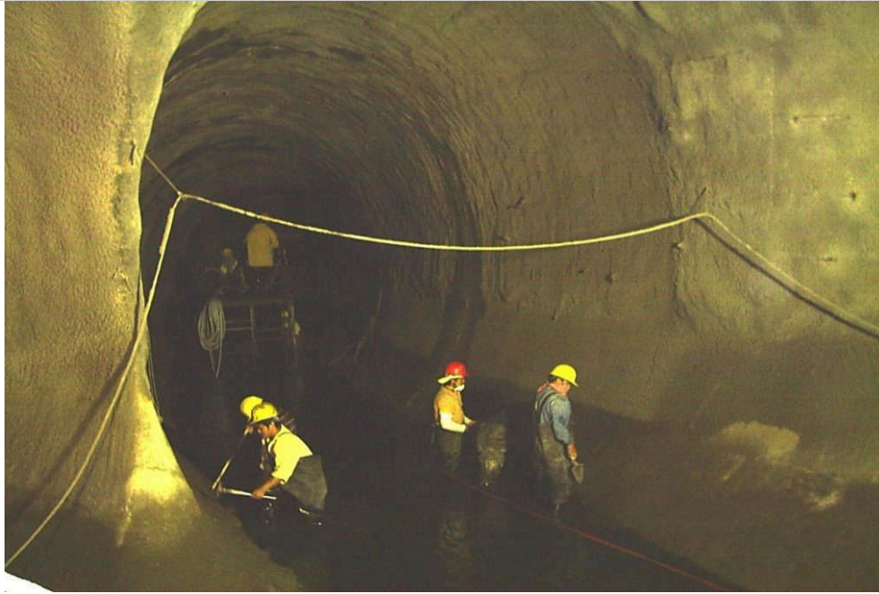
Figura 17.18. Deterioro en la clave del drenaje profundo e inspección en la cubeta
