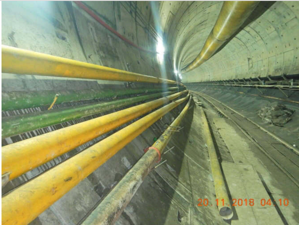
Figura 14.63. Tuberías de enfriamiento y agua residual en el túnel
