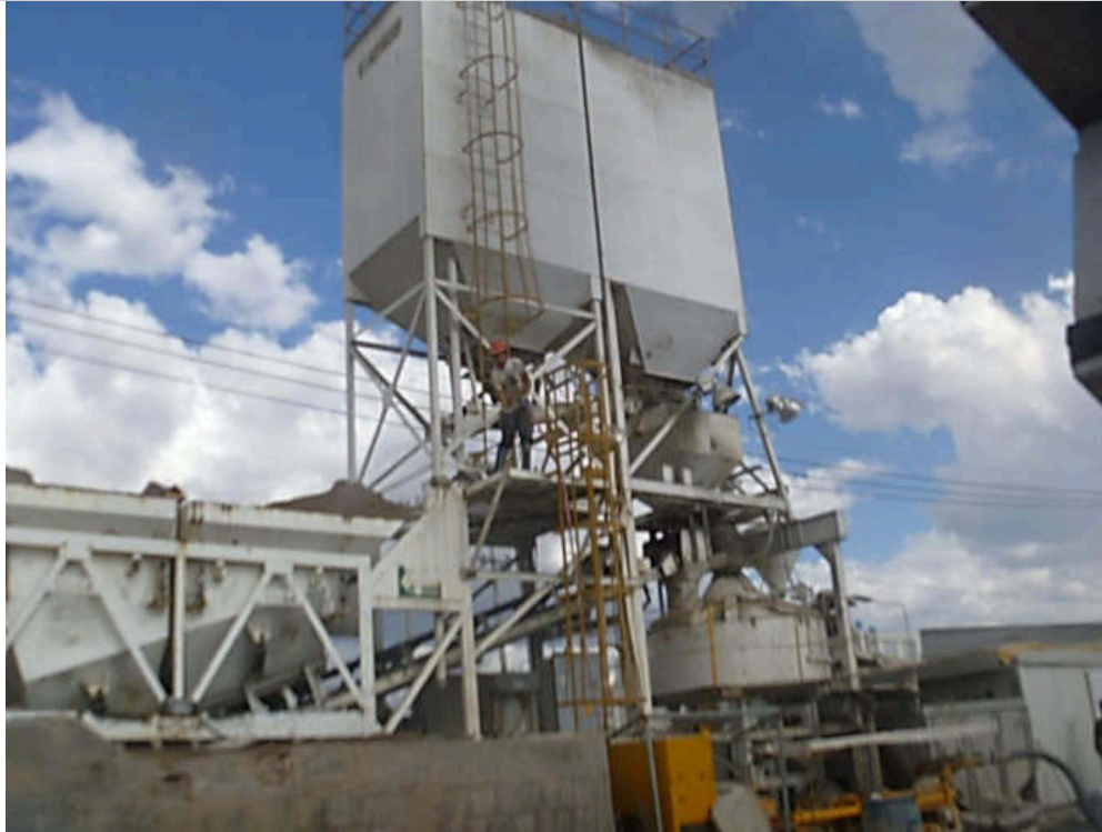
Figura 14.54. Planta dosificadora de mortero y bentonita
