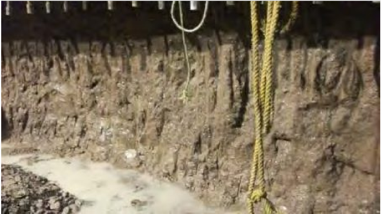
Figura 15.19. Filtración de agua en las paredes de la excavación de la L-18
