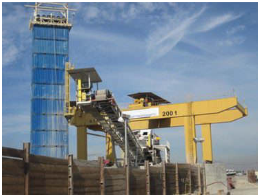
Figura 14.15. Sistema de rezaga con casete de banda vertical en la lumbrera 10
