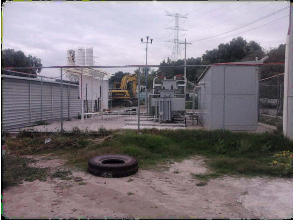
Figura 15.42. Subestación eléctrica en el portal de salida
