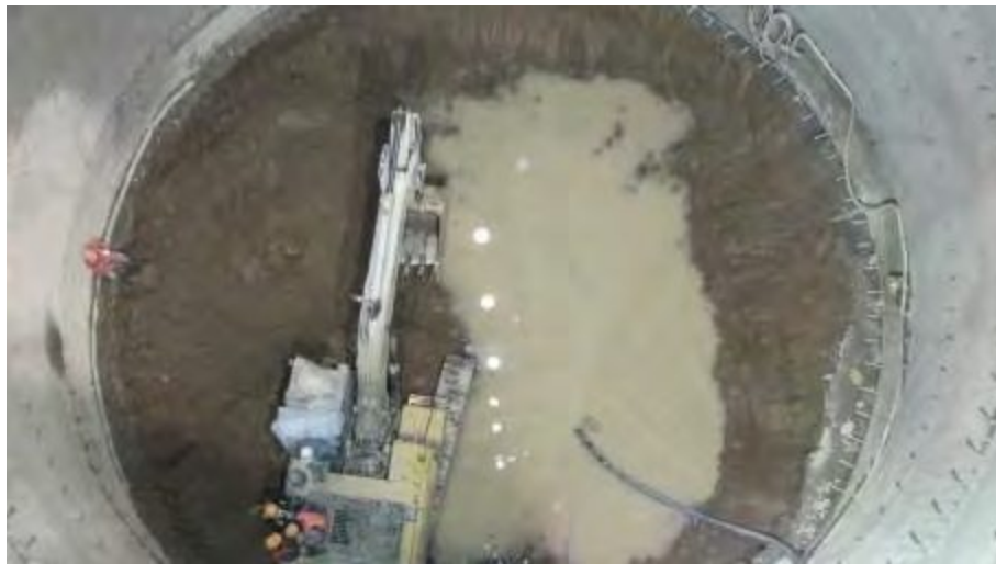
Figura 15.20. Acumulación de agua en el cárcamo de bombeo de la L-18
