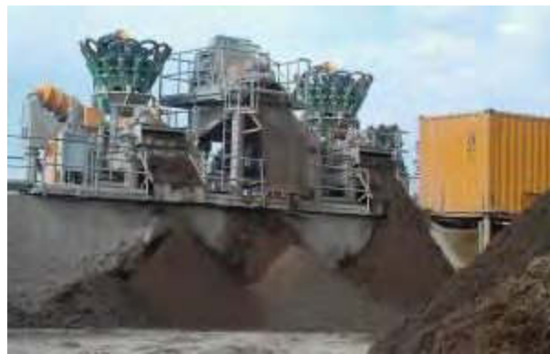
Figura 15.17. Planta de tratamiento de lodos bentoníticos de la L-18
