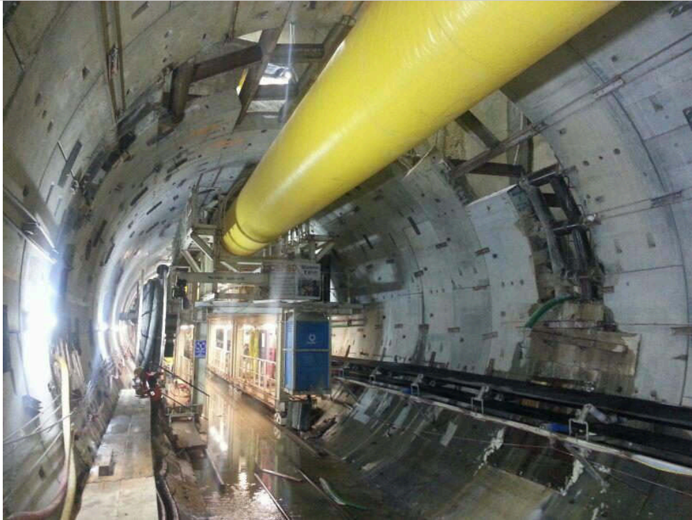
Figura 14.65. Manga de ventilación y cassette en el túnel
